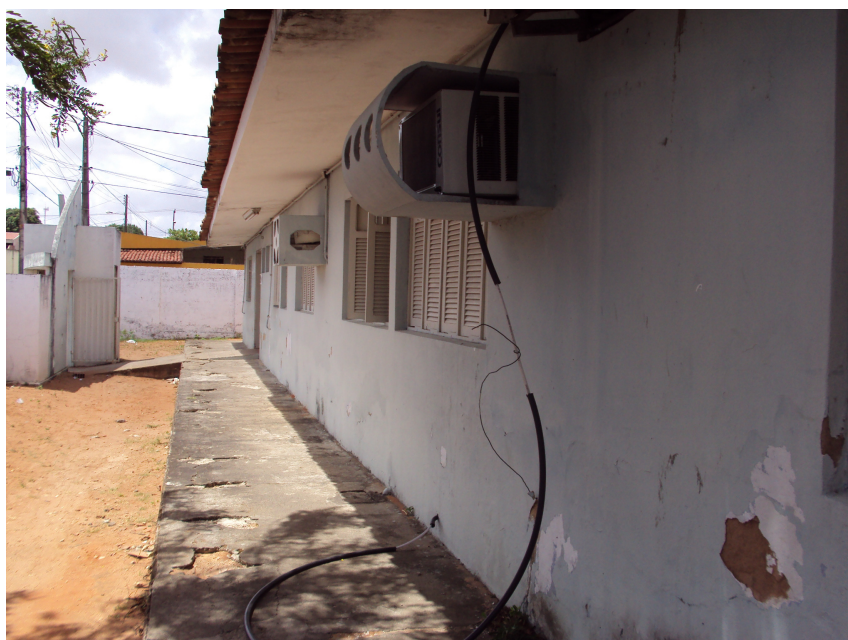
Foto 8 - USF NAZARÉ INSTALAÇÕES INADEQUADAS E MAL CONSERVADAS
