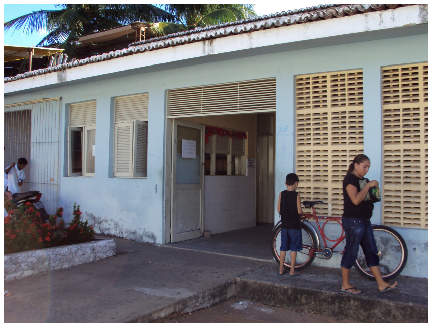
Foto 7 – USF MONTE LÍBANO PRÉDIO NECESSITANDO DE MANUTENÇÃO.
