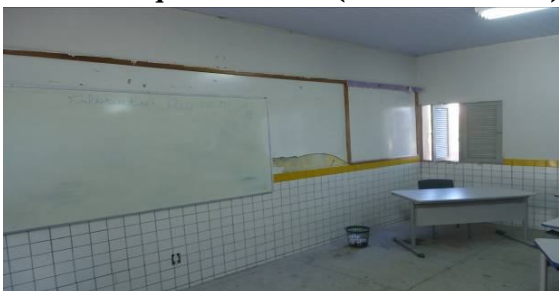
Figura 8 - Sala de aula da EE Joaquim Honório (lousa defeituosa)
