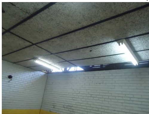
Figura 11 - Sala de aula da EE Prof. Francisco Ivo Cavalcanti (forro danificado)
