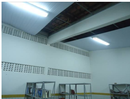
Figura 16 - Biblioteca da EE Demétrio Urbano (teto com forro danificado)
