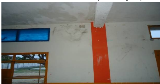
Figura 7 - Sala de aula da EE Tristão de Barros (infiltrações)
