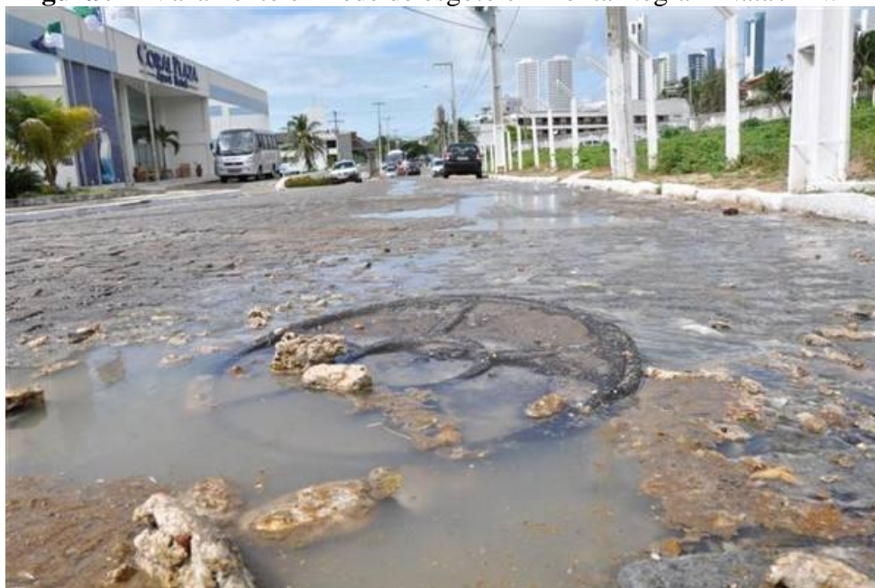
Figura 9 – Vazamento em rede de esgoto em Ponta Negra – Natal/RN.
