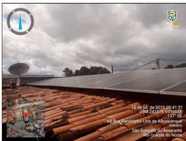
Figura 02 – Usina em telhado instalada na Secretaria de Educação
