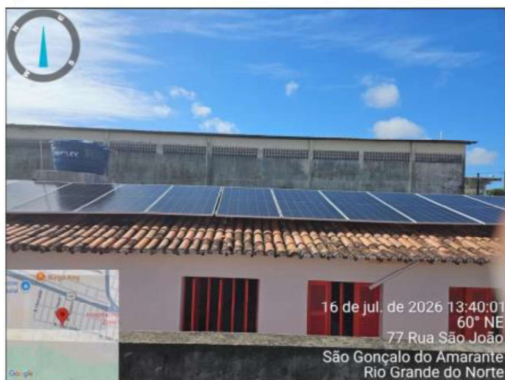
Figura 01 – Usina em telhado instalada na EM Profª. Maria da Cruz Bezerra
