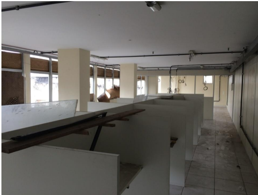
Figura 13 - Salas sem utilização por falta de reforma e adequação na SESED
