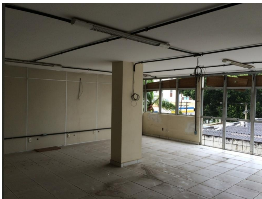
Figura 12 – Salas sem utilização por falta de reforma e adequação na SESED
